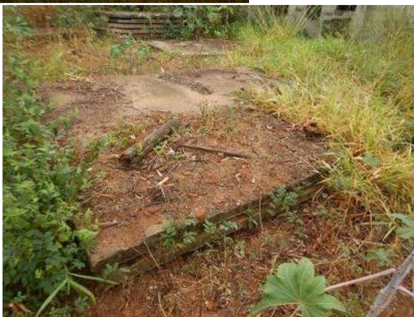
DETALHES DE LAJES CONCRETADAS ABANDONADAS NO LOCAL.
