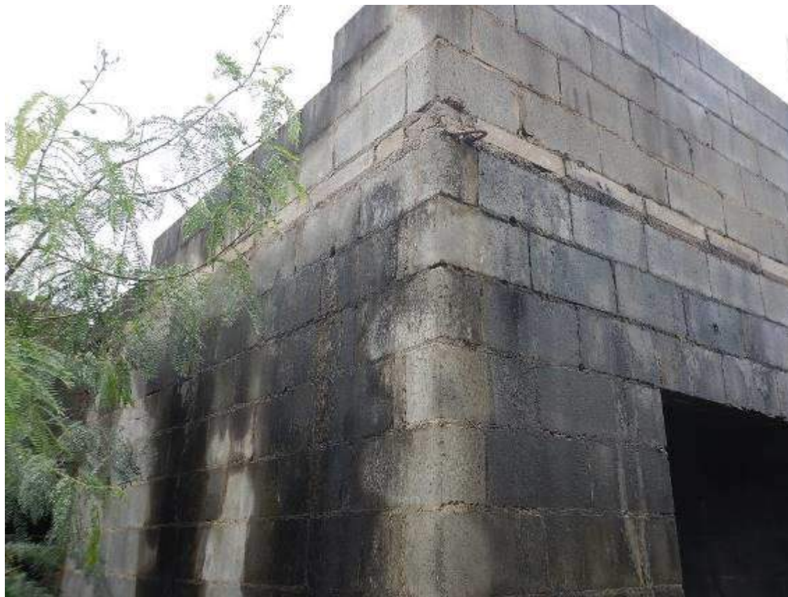
DETALHE DO DESGASTE DA ESTRUTURA.
