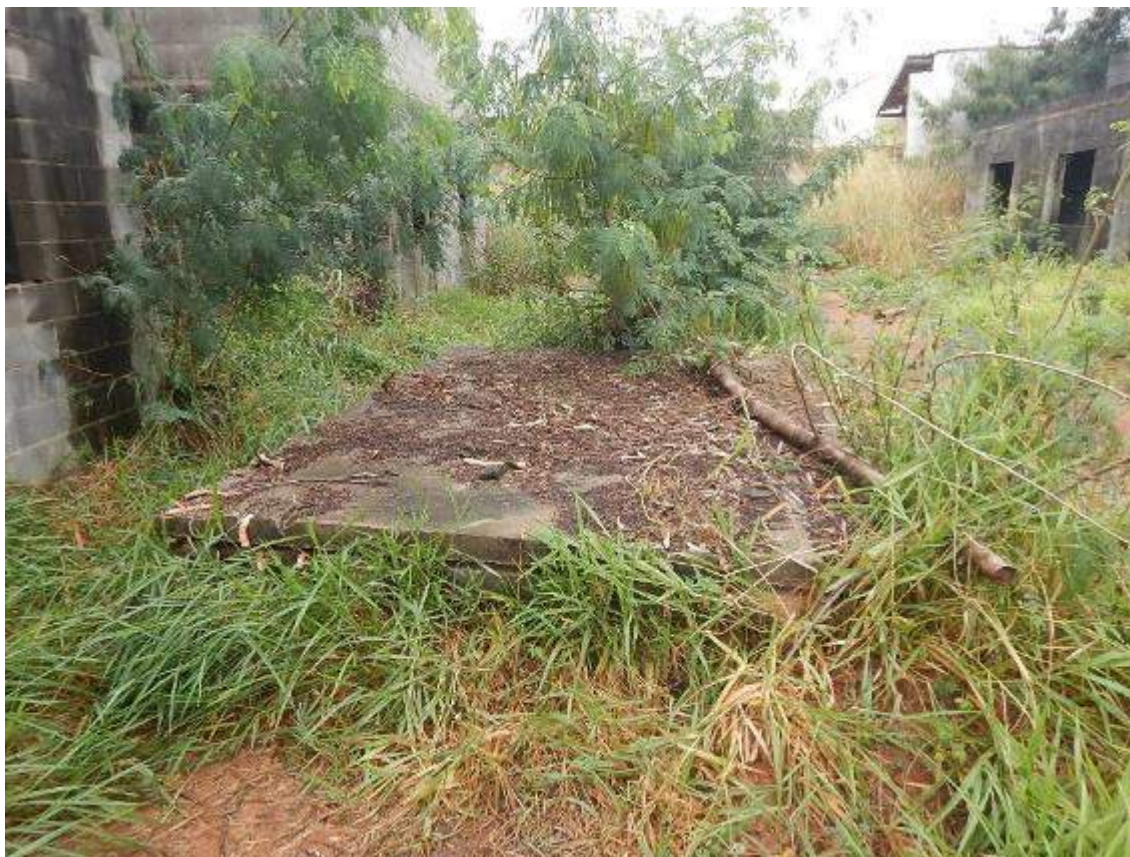
DETALHE DE MAIS LAJES CONCRETADAS ABANDONADAS NO TERRENO.
