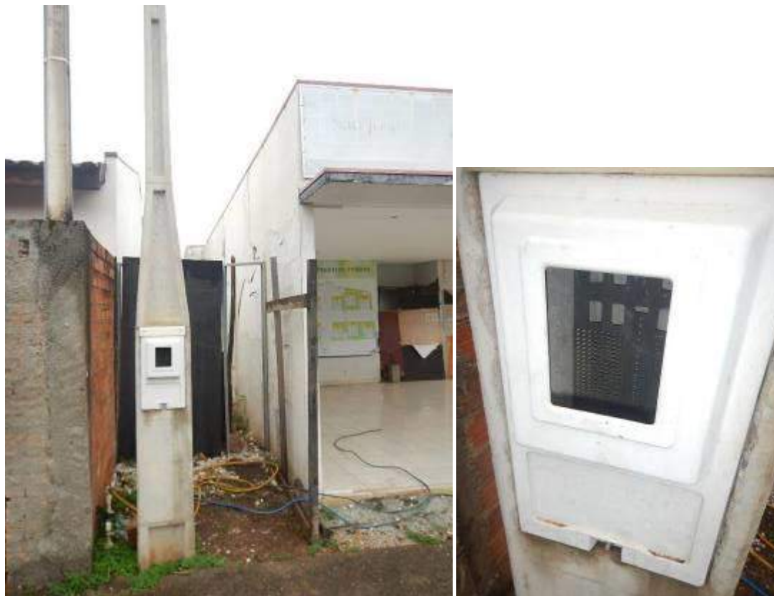
VISTA DA ENTRADA DE ENERGIA SEM LIGAÇÃO.
