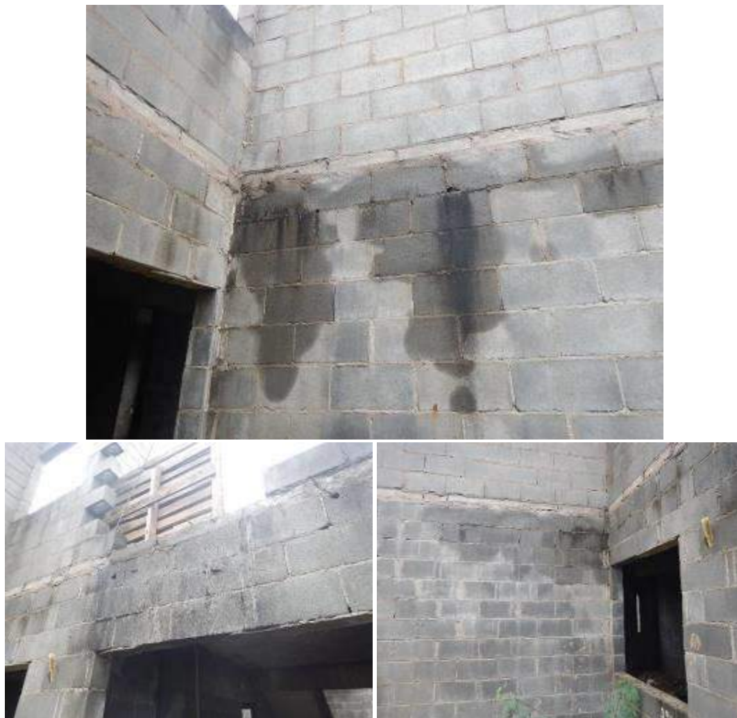
UMIDADES E DANOS NA ESTRUTURA DO BLOCO 12.
