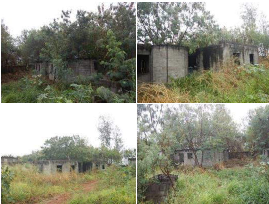
MAIS VISTAS DOS BLOCO 2, 3, 4 E 5, ABANDONADOS APÓS CONCRETAGEM DA PRIMEIRA LAJE.
