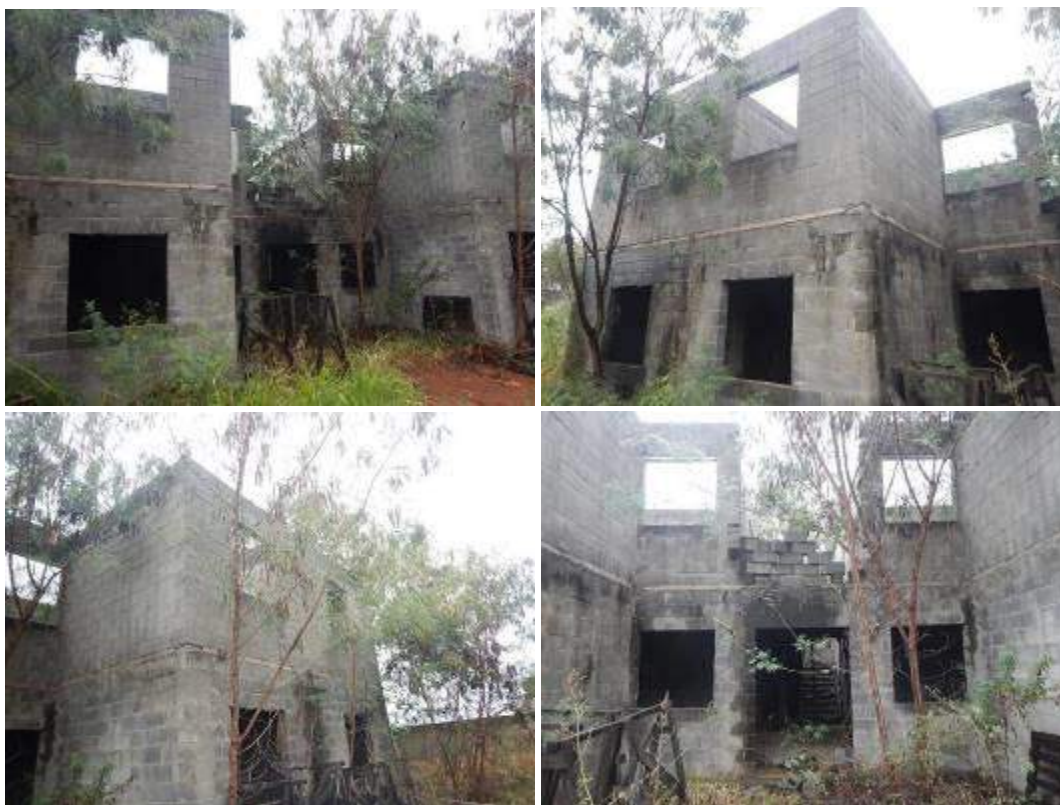
VISTAS DAS CONSTRUÇÕES ABANDONADAS, EM AVANÇADO ESTADO DE DETERIORAÇÃO.
