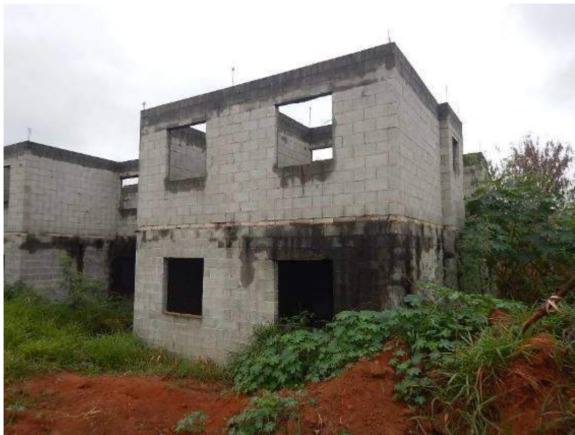
BLOCO 1, PODENDO-SE NOTAR A CONSTRUÇÃO PARALISADA.
