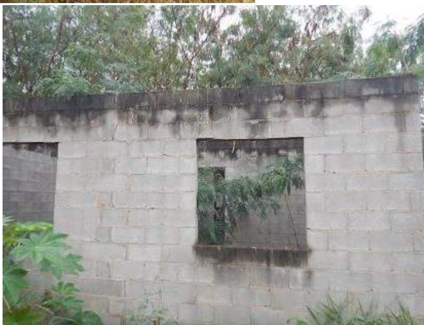
DETALHES DAS ESTRUTURAS DANIFICADAS PELAS INTEMPÉRIES.
