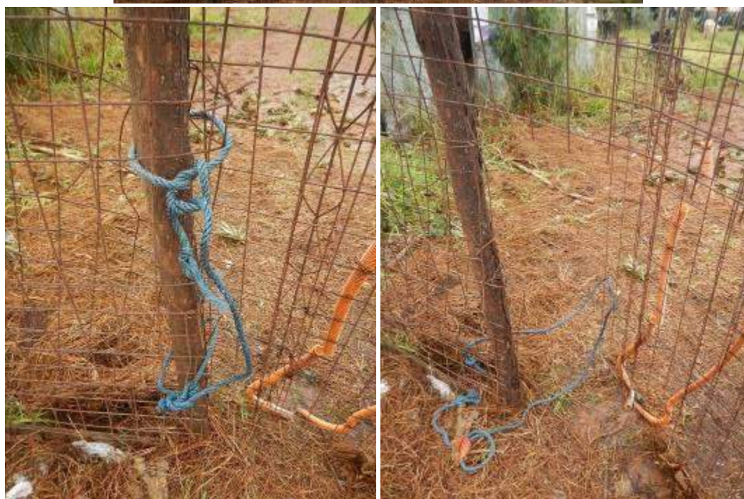
FECHAMENTO PRECÁRIO DO IMÓVEL, COM TELAS DE AÇO (ARMADURA DE LAJE) AMARRADAS COM CORDAS.
