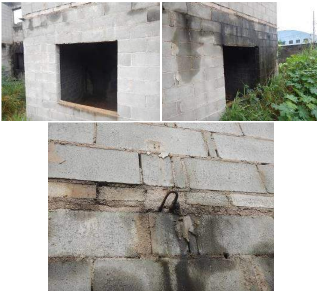
DETALHES DA UMIDADE DOS BLOCOS, BEM COMO AMADURA COM INÍCIO DE CORROSÃO.
