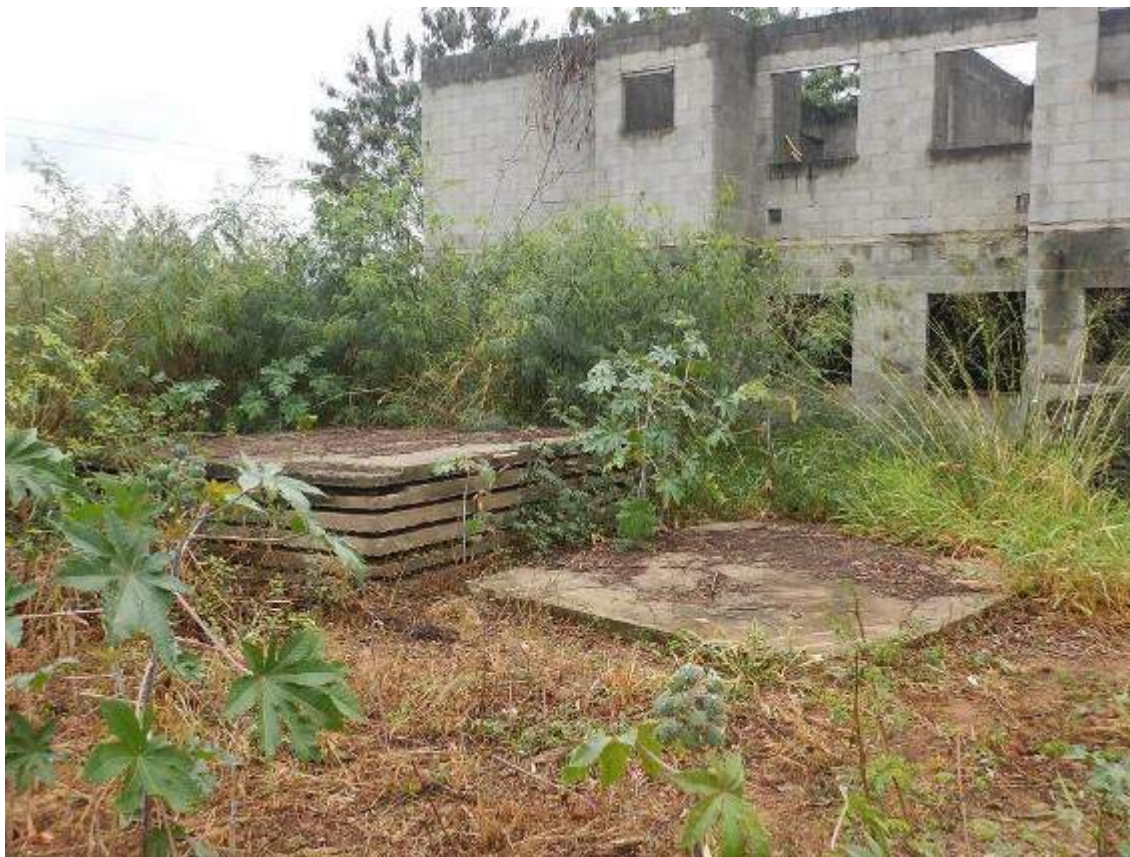
VISTAS DE MAIS LAJES JÁ CONCRETADAS, ABANDONADAS NO LOCAL.
