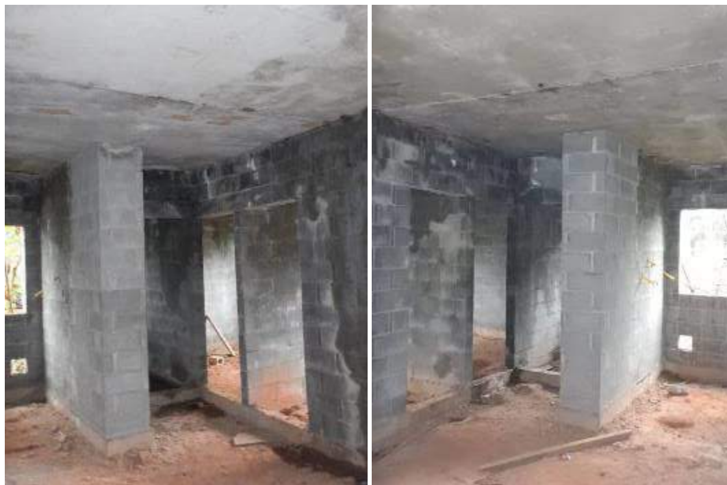
VISTAS DOS APARTAMENTOS DO TÉRREO DO BLOCO 1, PODENDO-SE NOTAR SEVERAS INFILTRAÇÕES E AUSÊNCIA DE CONTRAPISO DE CONCRETO.
