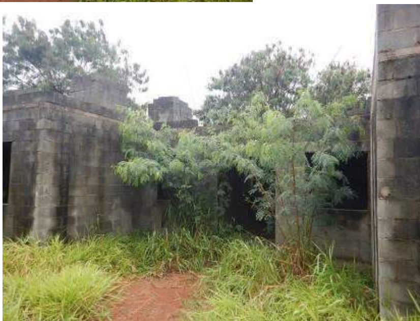
MAIS VISTAS DA CONSTRUÇÃO ABANDONADA DO BLOCO 10.
