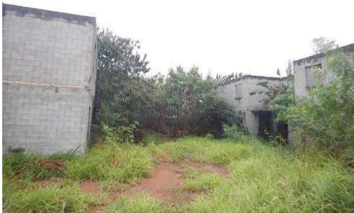
VISTAS DOS BLOCOS 9 E 10, PARALISADOS.
