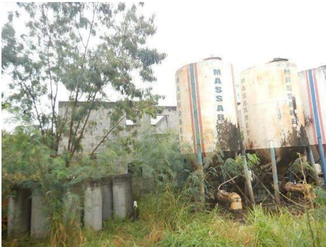
OUTRA VISTA DO BLOCO 7, PODENDO-SE NOTAR OS EQUIPAMENTOS ABANDONADOS NA OBRA.
