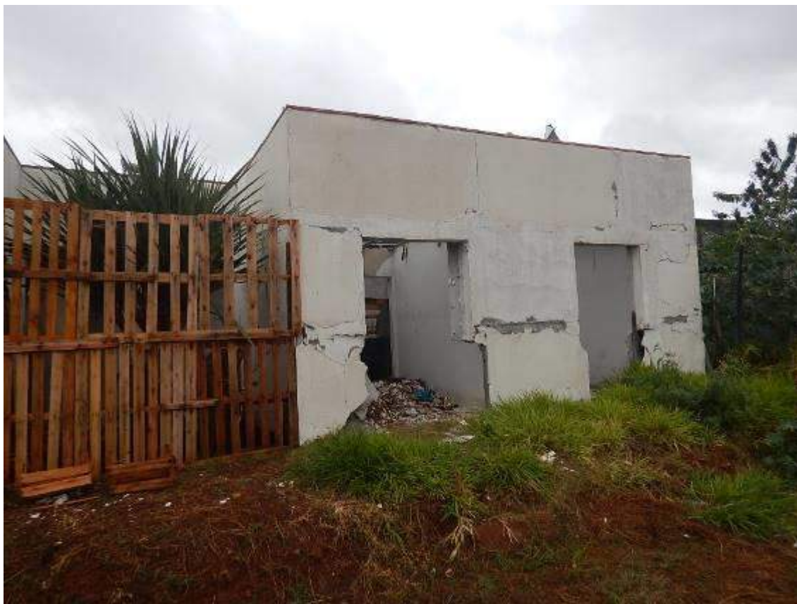
CONSTRUÇÃO PROVISÓRIA PARCIALMENTE DESTRUÍDA.
