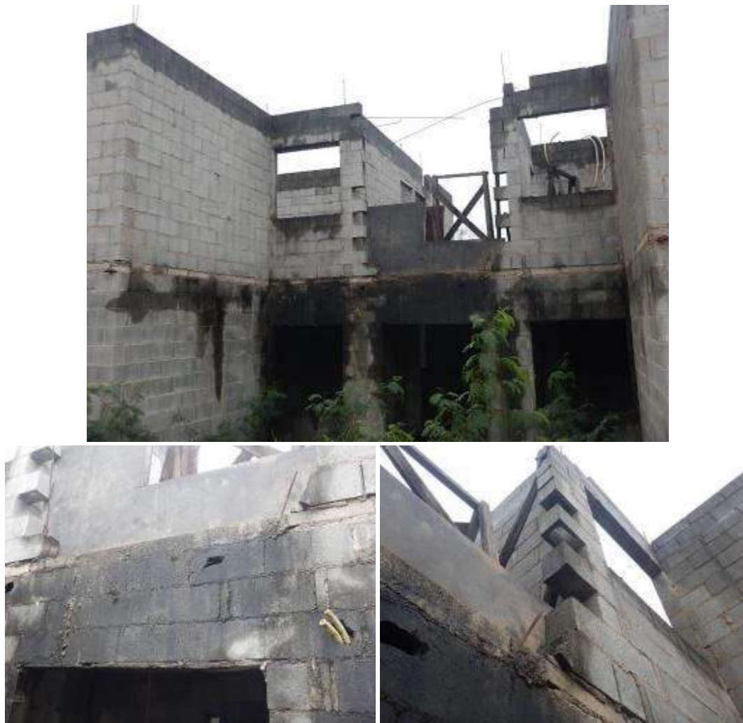
MAIS VISTAS DO BLOCO 1, INACABADO.
